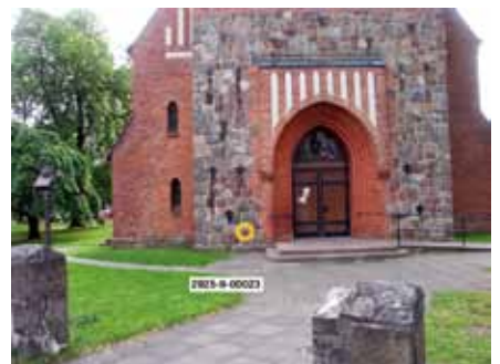
Abb. 11: Mauerbolzen an der ev. Kirche in Bispingen
