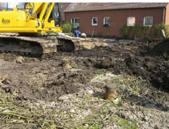
Abb. 2: Zerstörung von Rohrfestpunkten des Höhenfestpunktfeldes infolge von Bauarbeiten
