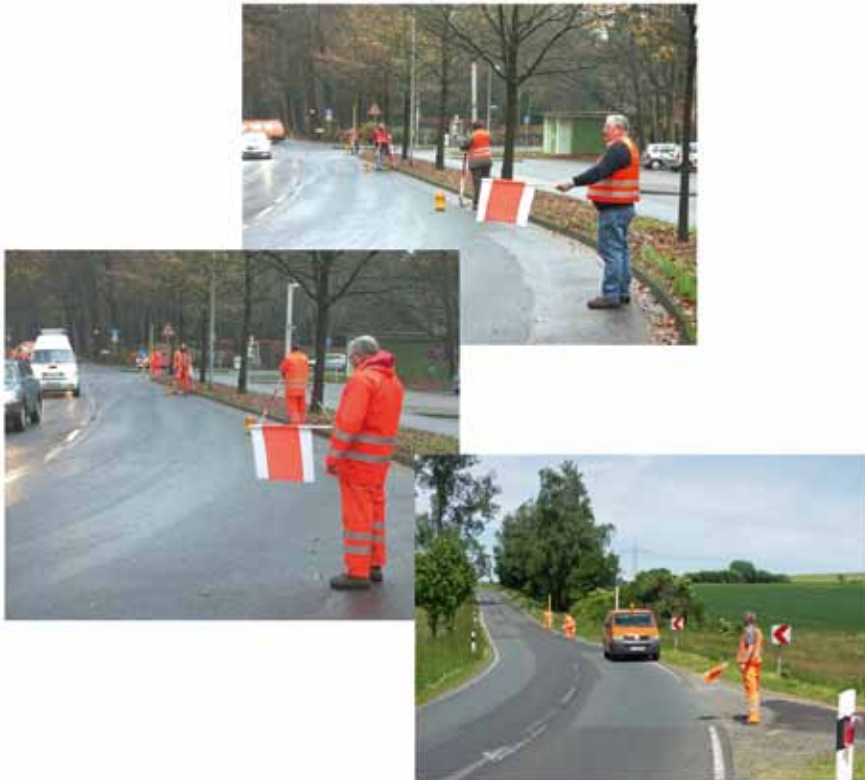
Abb. 9: Wirkung der Warnkleidung Klasse 2 und Klasse 3 sowie zusätzliche Sicherung durch ein Messfahrzeug
