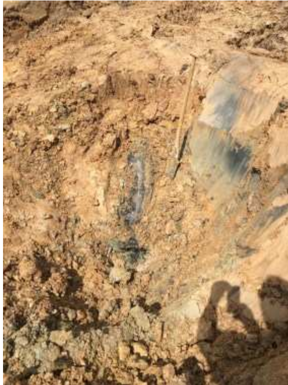
Abb. 2: Fund einer amerikanischen 5-Zentner Bombe am 29.09.2016 auf dem Hanomag-Gelände in Hannover und großes Glück für den Baggerführer
